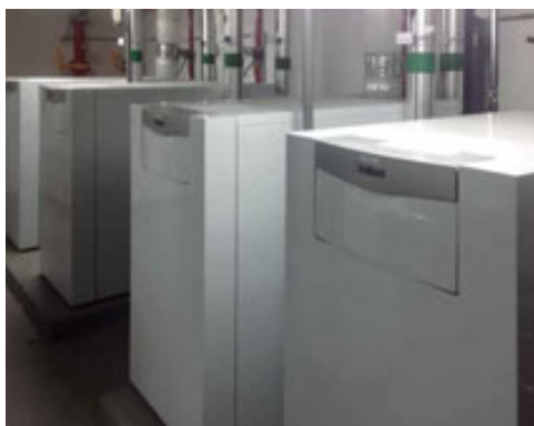
Sala de calderas con cascada de calderas ecoCRAFT exclusiv en Colegio mayor Pio XII (Madrid).
